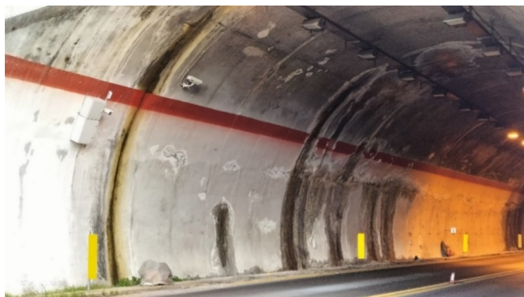
Figura 6 - Imbocco - Macchie ed infiltrazioni
