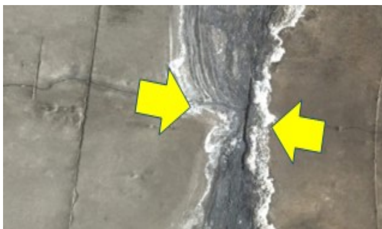
Figura 9 - Fessura rivestimento galleria
