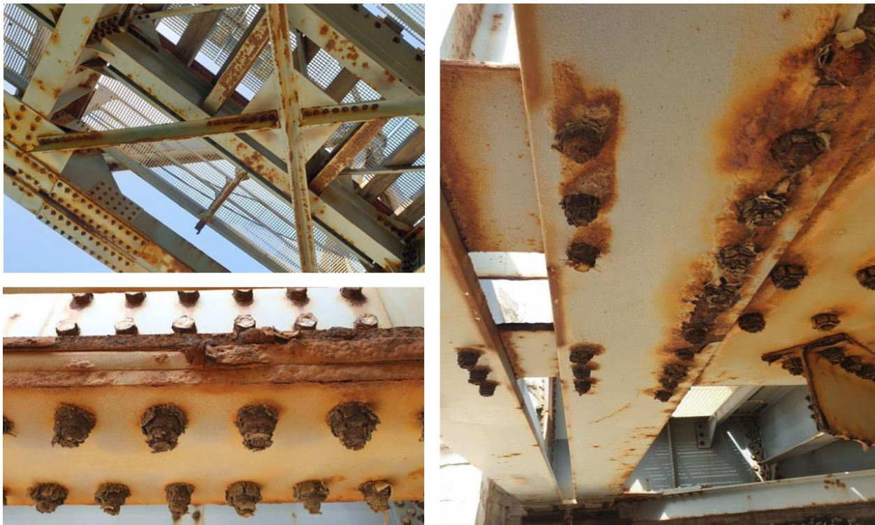
Figura 4 - Corrosione sui giunti bullonati
